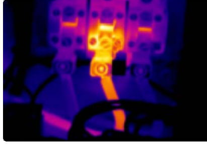
電線接頭鬆動
